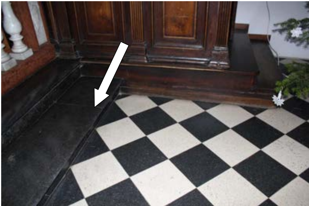
Fot. 4. Posadzka prezbiterium stopnie z ciemnego marmuru szwedzkiego, widok na stopnice przy stallach, stan na 2023 rok.
