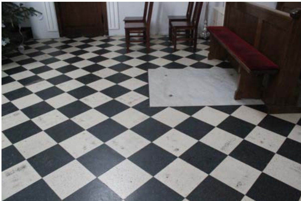
Fot. 28. Wtórna posadzka nawy głównej wykonana z płyt lastryko, widoczny element płyty do krypt.
