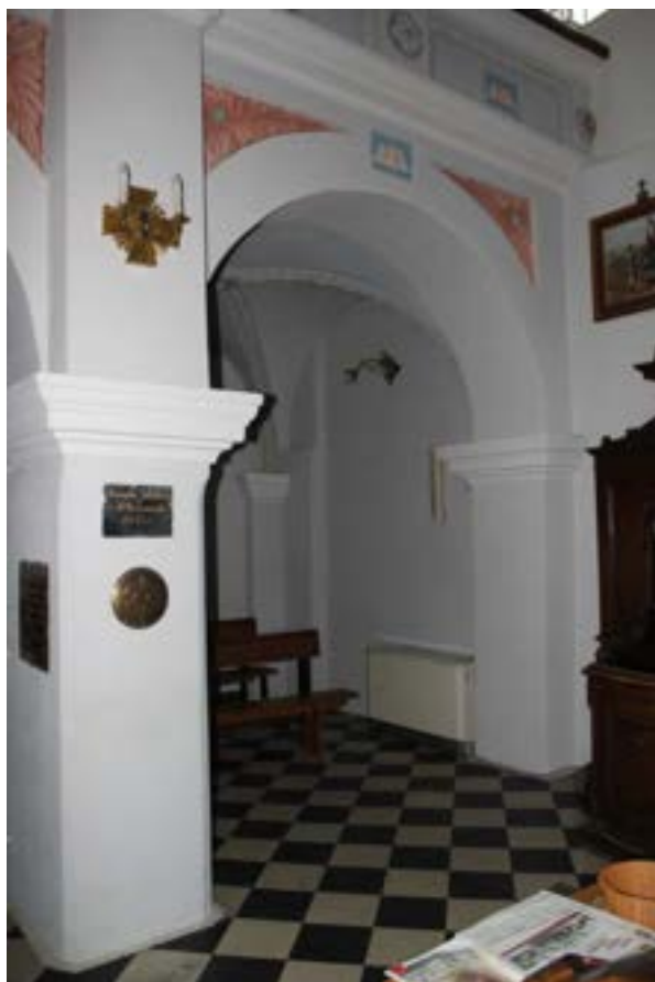
Fot. 26. Wtórna posadzka nawy głównej wykonana z płyt lastryko, widok na kruchtę.
