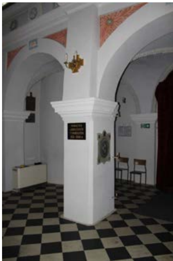
Fot. 27. Wtórna posadzka nawy głównej wykonana z płyt lastryko, widok na kruchtę.
